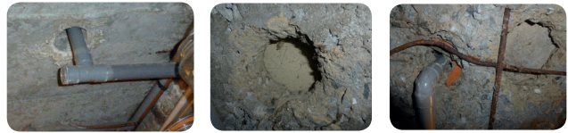
I Défauts d'étanchéité de réseaux dans la dalle du plancher sur cave
