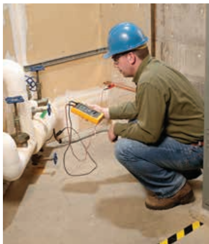
Les mesures de résistance de la terre peuvent être prises sur les conduites d'eau métalliques si nécessaire.
