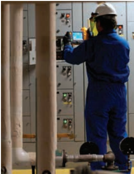
Les caméras infrarouges permettent de détecter en toute sécurité les problèmes passés inaperçus sur les systèmes et les équipements électriques.
