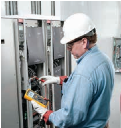
Un mégohmmètre permet de mesurer la résistance de l'isolement sur les équipements et les systèmes électriques.
