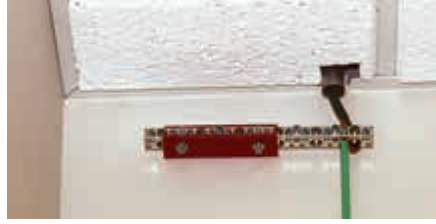
Les conducteurs des systèmes de mise à la terre sont généralement identifiables par la présence d'une gaine isolante de couleur verte.
