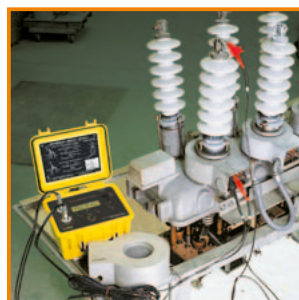
Mesure du rapport d'un transformateur de courant
