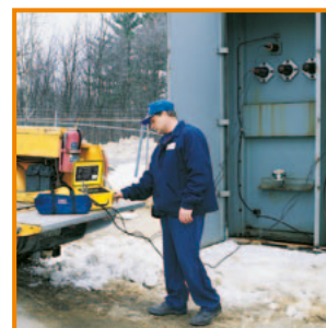
Sur le terrain, mesure sur transformateur triphasé 2000 kVA
