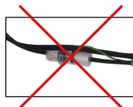
冷凝水槽 错误
