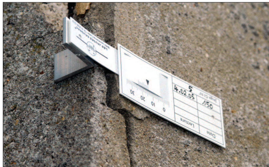
Pose d'une jauge G1 sur fissure de rive avec une cornière aluminium
