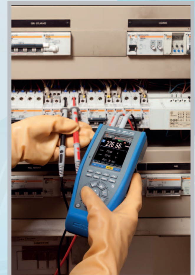
Mesures sur armoires électriques
