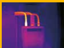
Mauvaise connexion et détérioration interne
