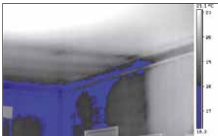
L'alarme d'humidité relative vous signale les zones où la condensation risque d'apparaître. Dans l'image ci-contre, c'est le cas de la zone en bleu.
