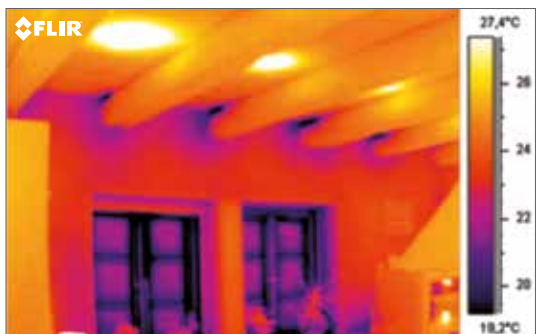
Ponts thermiques entre les poutres du toit et les murs.
